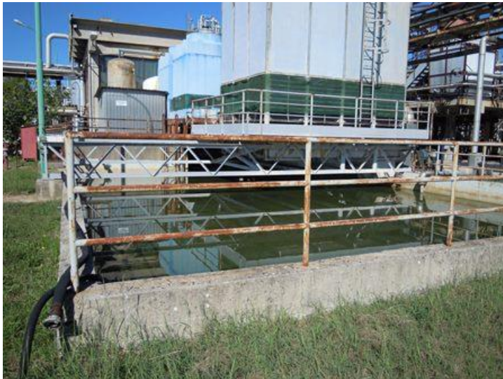
Slika 1: Požarni bazen v podjetju
